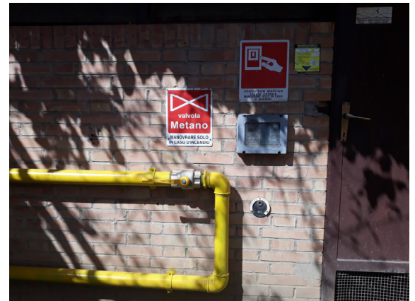
Figura 3 Manopola interruzione erogazione metano
